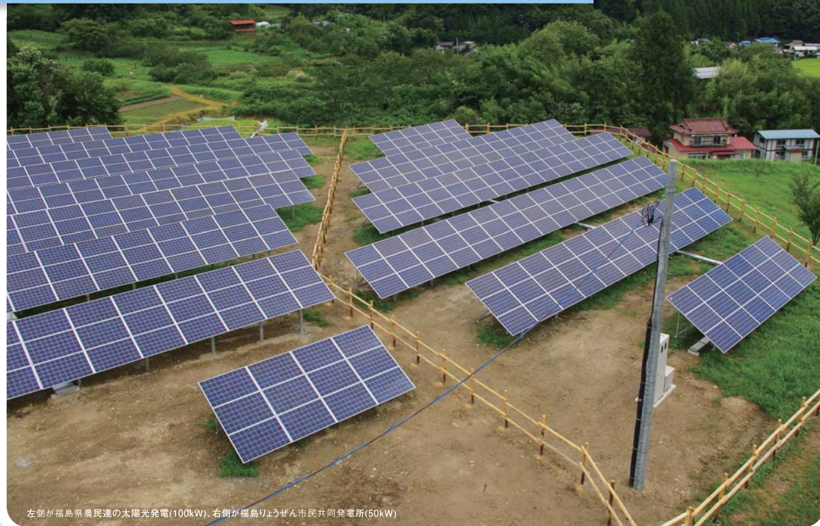
左側が福島県農民連の太陽光発電(100kW)、右側が福島県ようぜん市民共同発電所(50kW)
